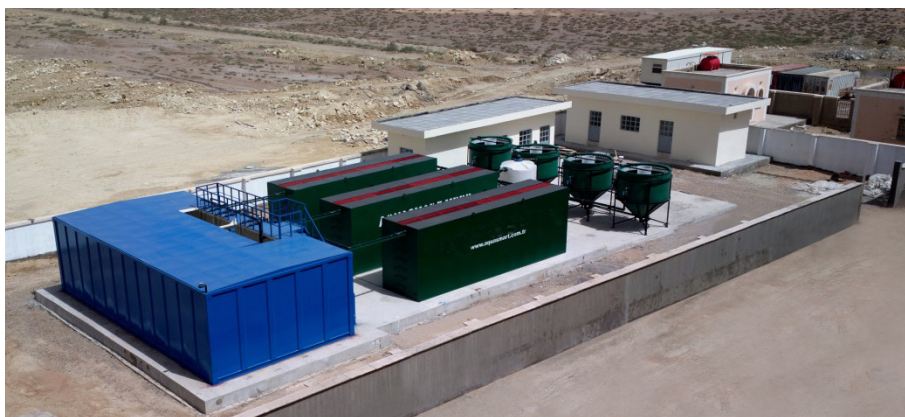
Bild 5: Container-Kläranlage mit Mutag BioChip™, aufgestellt Ende 2014 im Irak
