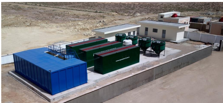
Bild 5: Container-Kläranlage mit Mutag BioChip™, aufgestellt Ende 2014 im Irak
